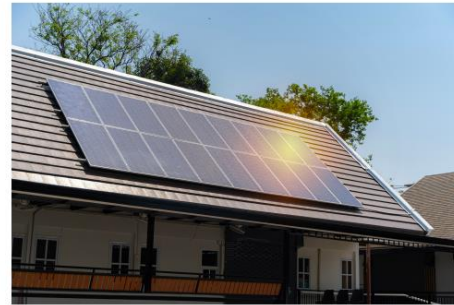
Slika 9. Solarna elektrana na krovu kuće (izvor: Canva)
